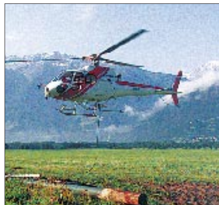
Ohne Hubschrauber wäre der Transport des neuen stabilen Mastes wohl nicht zu lösen gewesen. Fotos: IW3BRC
