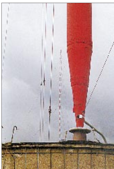
Gegen Erde isolierter Mastfuß eines 216-m-Vertikalstrahlers mit Funkenstrecke und Speiseleitung, im Hintergrund der 325-m-Mast
