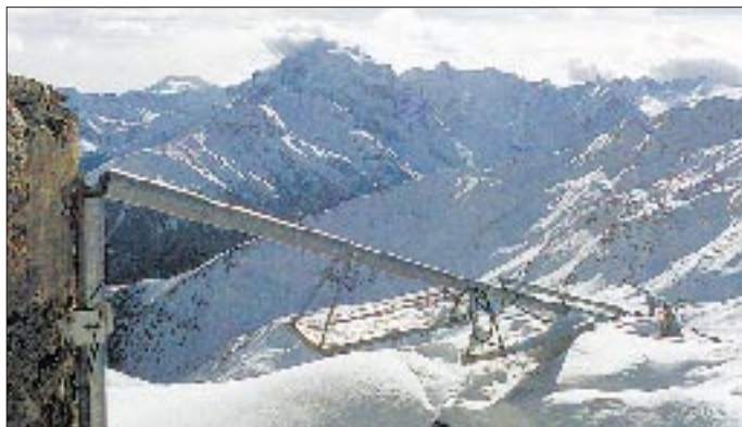
Die Wurzel allen Übels: der geknickte Mast. Daneben die freigeschaufelten Solarpaneele
